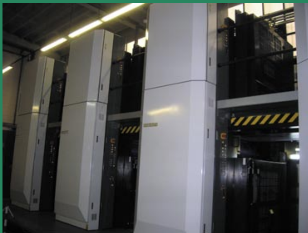
La rotativa Komori System 38 D da 32 pagine, completamente robotizzata, installata presso Roto3 di Castano Primo (MI)
